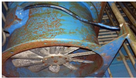
Gambar 17. Motor Listrik Blower (Sumber: KM BINTANG MAS MURNI, 2019)
